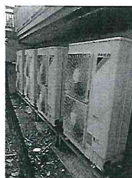
ระบบปรับอากาศของร้านฯ
