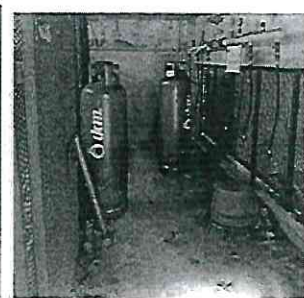
จุดวางถังและท่อส่งแก๊ส
